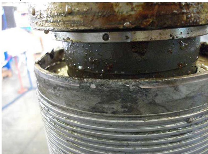
Очень сильная коррозия обнаружена на резьбовом соединении ниппеля корпуса клапана.
